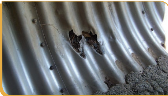
Tuberías agrietadas y quebradas pueden causar hundimientos en su propiedad; repare o reemplace tuberías de agua pluviales.
