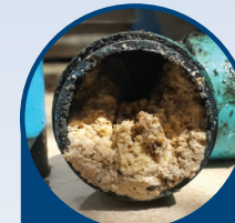
Tapones de FOG en la línea de alcantarillado
